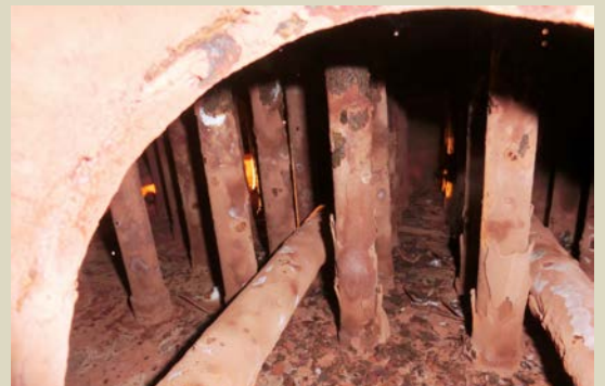
Bauteiluntersuchungen, z. B. der Stehbolzen im Kessel Foto: Pedro Scheibenhuber
